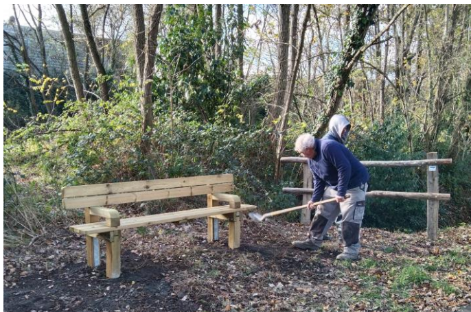
Pose de mobilier bois et de signalétique (bancs, barrières, lames directionnelles...) sur la voie verte à Châteaubriant pour la CCCD.
